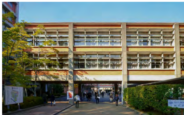
(改修前) 外壁の退色やルーバーの垂れ等の劣化状況
