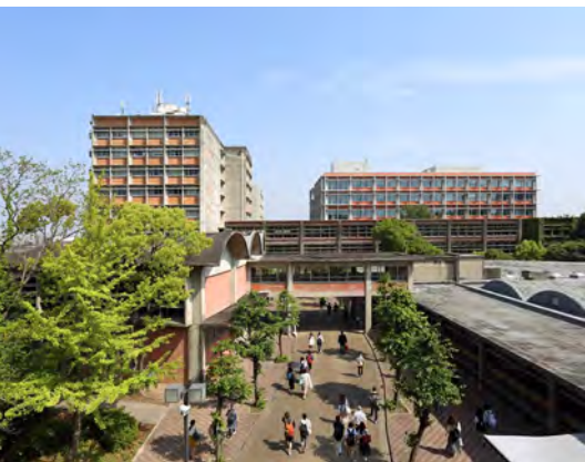
(改修前) 劣化の見られる外壁・屋上防水※※
